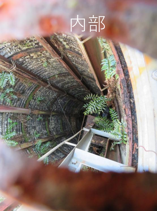
崩れた後の土留
